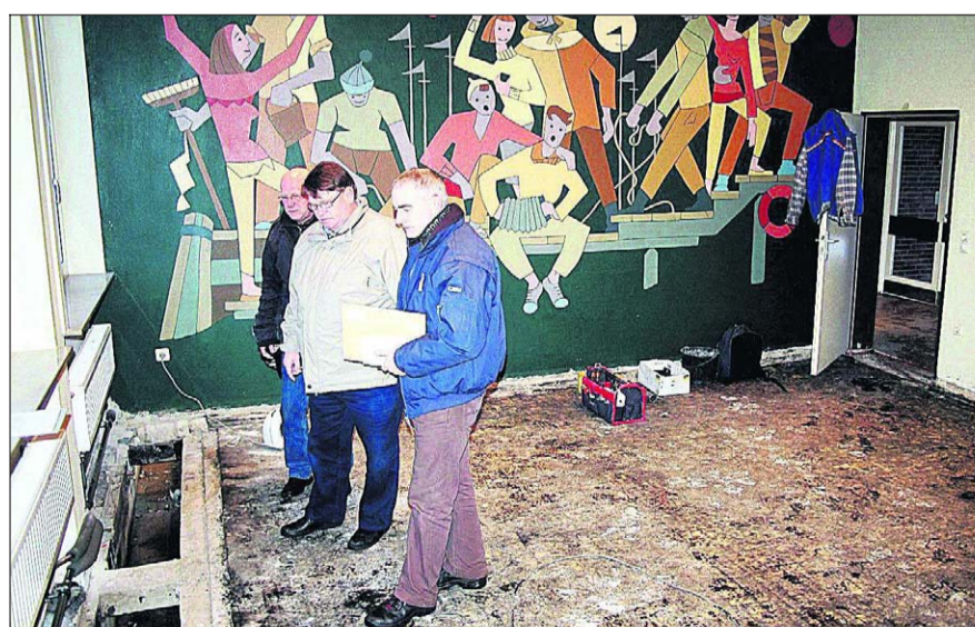
Bürgermeister Jens Heinze (Mitte), Mönkebergs Gemeindebüroleiter Robert Sell (links) und Hausmeister Thorsten Wulff machten sich gestern ein Bild vom Stand der Sanierungsarbeiten im Mönkeberger Jugendheim. Foto Kuhl
